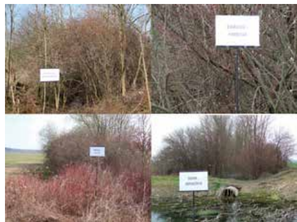
Slika 5: Fotografski prikazi (kao primjeri) dokaza stanja neobnovljenih melioracijskih kanala III. i/ili IV. reda (Izvor: „Drenaža zemljišta Hrvatske“, Petošić, 2021.).
