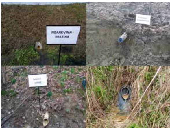
Slika 8: Fotografski prikazi kao primjeri dobrog stanja hidromelioracijskog sustava podzemne odvodnje – cijevne drenaže (2017. – 2019.) (Izvor: „Drenaža zemljišta Hrvatske“, Petošić, 2021.).
