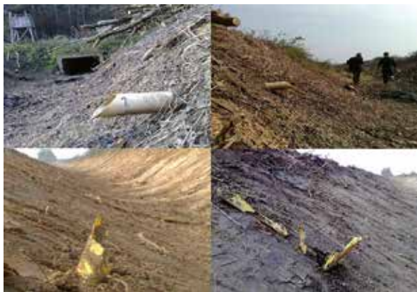
Slika 9: Prikaz oštećenja i devastacije sustava cijevne drenaže u postupku obnove melioracijskih kanala III./IV. reda (Zagrebačka županija, Božjakovina). Zbog izostanka kontrole kod izvođenja radova uočljivo je praktično potpuno uništenje (devastacija) izljeva drenažnih cijevi (dolje) (Izvor: „Drenaža zemljišta Hrvatske“, Petošić, 2021.).
