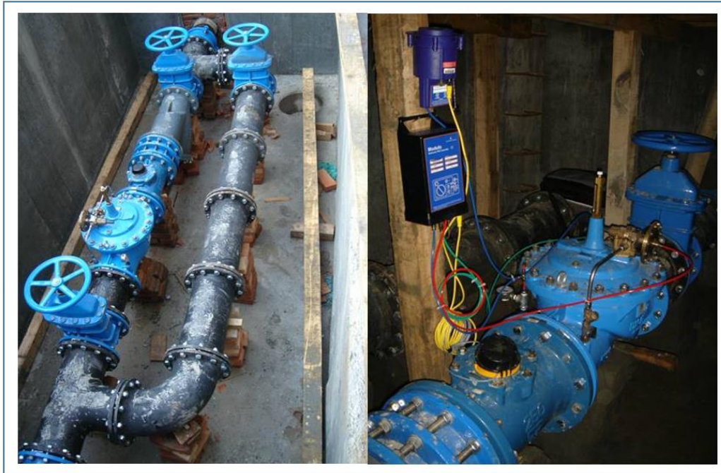
Slika 5.7: Mjerno upravljačke komore [33];
