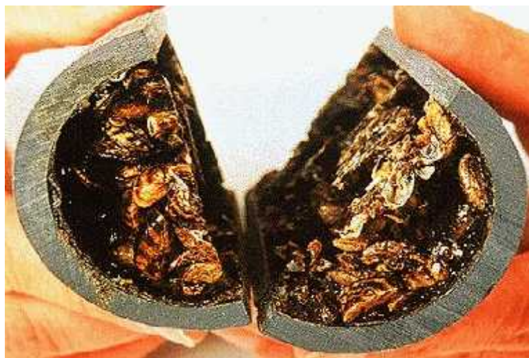
Slika 3. Obraštaj vrste D. polymorpha unutar vodovodnih cijevi
