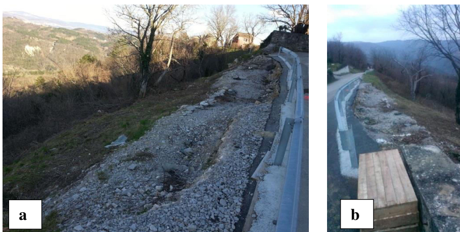
Slika 3.1 (a,b) Čeona pukotina klizišta Sovinjak a rubu ceste s denivelacijom gornjeg dijela pokrenute mase u iznosu od 0,95 m (snimio Ž. Arbanas 14.2.2015.).
