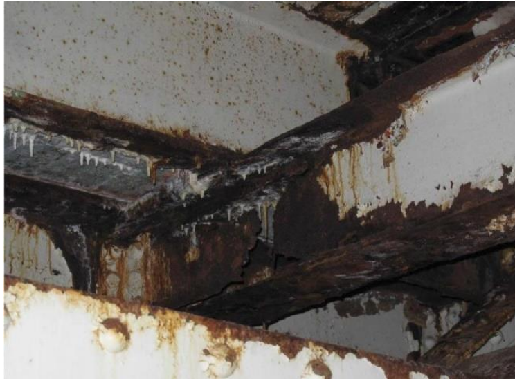
Slika 14. Korozija u procijepu čelične konstrukcije mosta [18]
