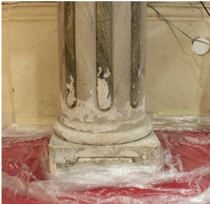
Sl. 45 – Baza stupa s oštećenjima u svim stratigrafskim slojevima
