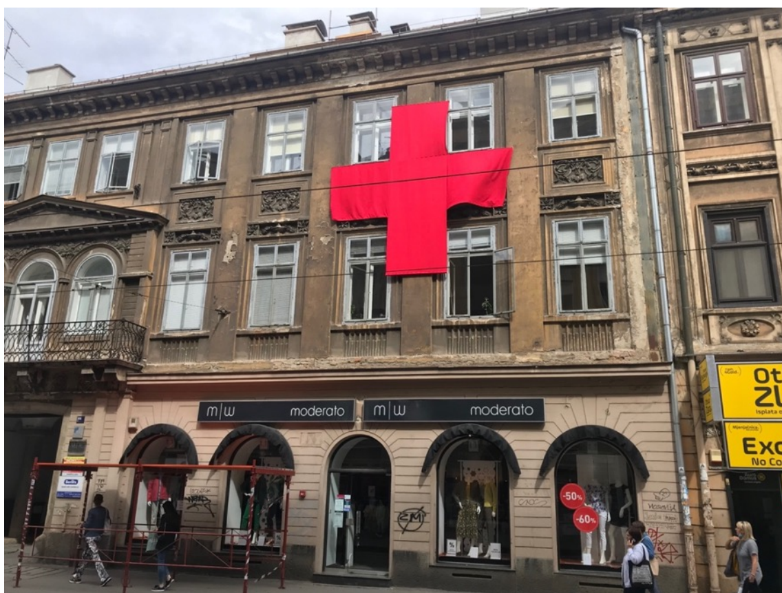
slika 23. Crveni križevi na oštećenim zgradama u potresu, Ilica 44, Zagreb, 2020.
