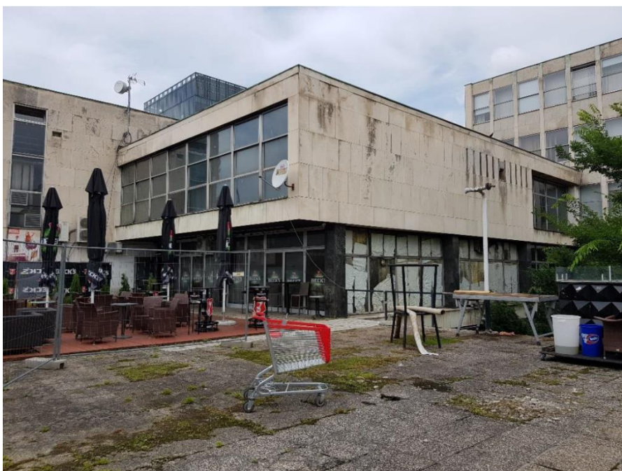
Slika 42. Zgrada Radničkog sveučilišta "Moše Pijade", Ulica grada Vukovara 68, pogled na vanjska pročelja Kluba i predvorja u prizemlju sa vanjske terase 279
