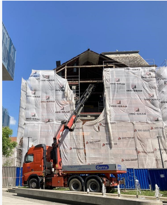
Slika 35.: Prikaz rastvorenog zabatnog zida na južnom pročelju istočnog kraka, 2023. godina
