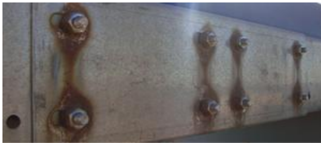
Slika 2. Galvanska (kontaktne) korozija [4]
