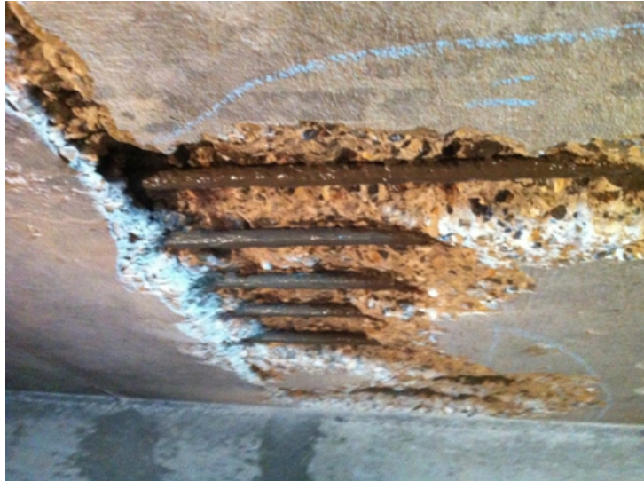
Slika 3: Prikaz korozije u armiranom betonu 7
