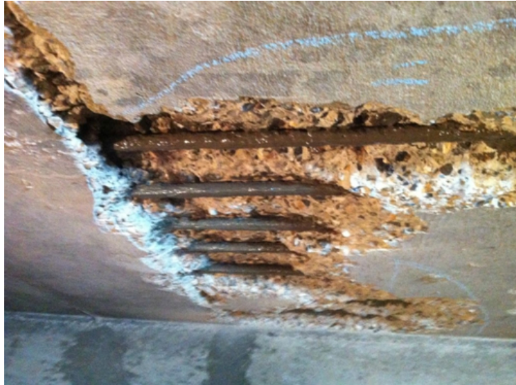
Slika 3: Prikaz korozije u armiranom betonu 7
