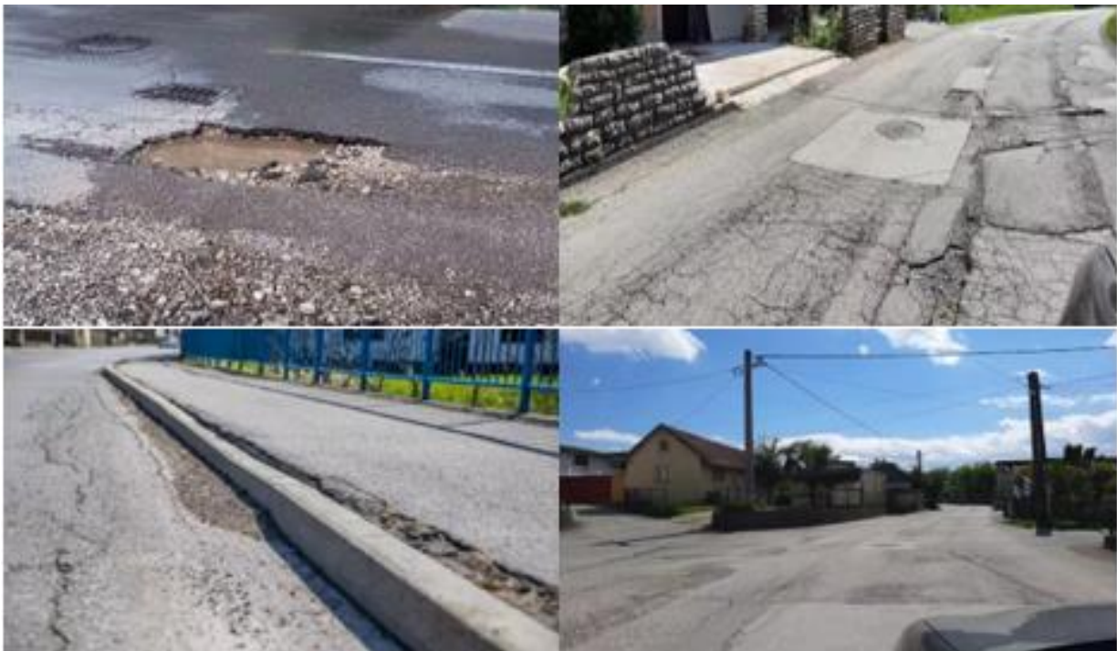
Slika 4. Oštećeni kolnici na području Karlovačke županije
