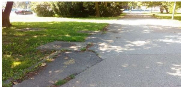
Slika 19. Prikaz loše uočljive horizontalne signalizacije
