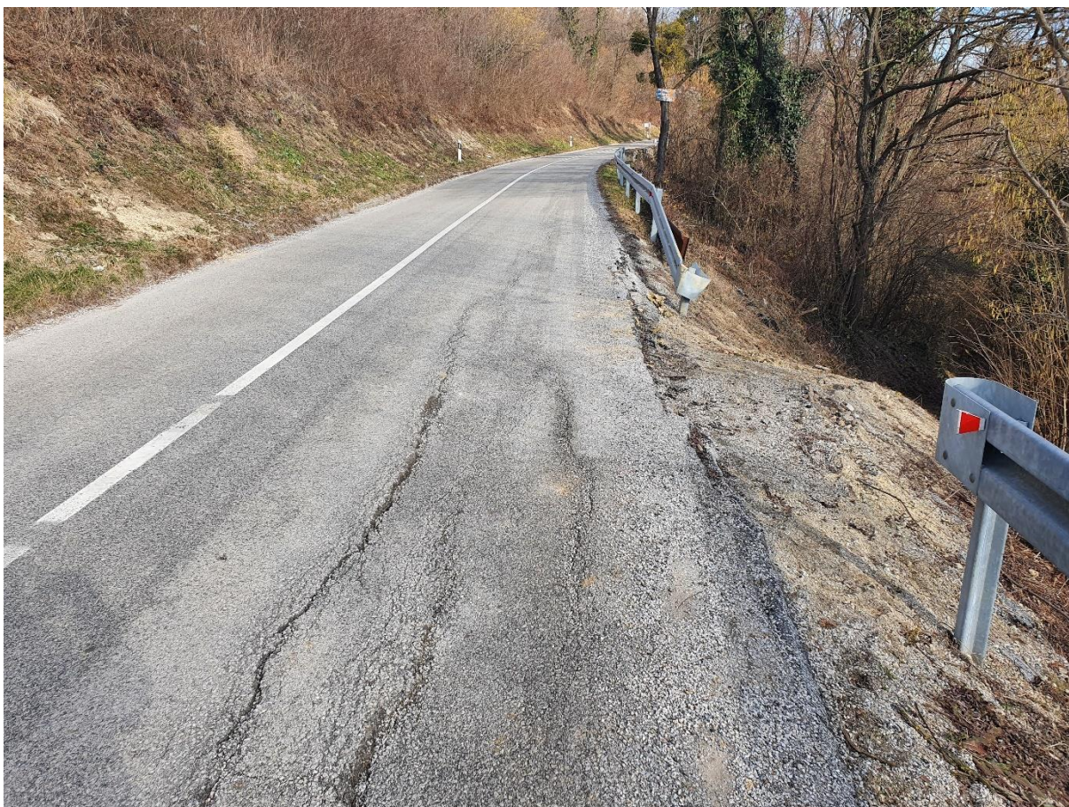
Slika 24: Stanje klizišta prije sanacije
