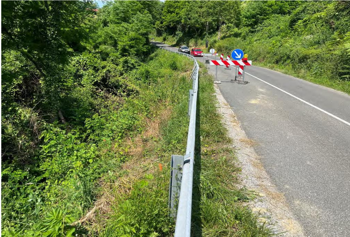
Slika 39: Zatečeno stanje klizišta
