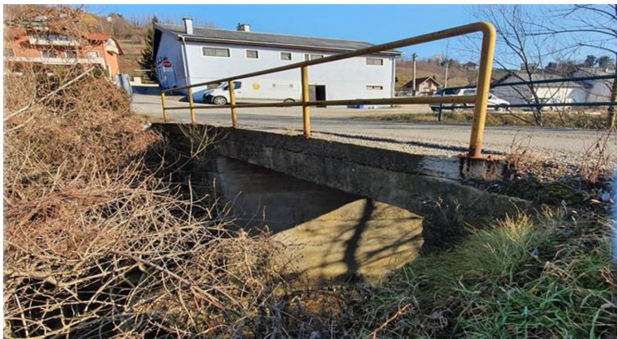
Slika 35: Stanje propusta prije sanacije
