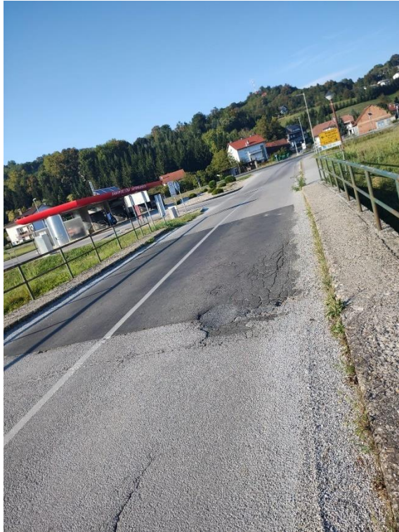
Slika 5: Oštećenje kolničkog zastora na županijskoj cesti ŽC2155 (Klokovec)
