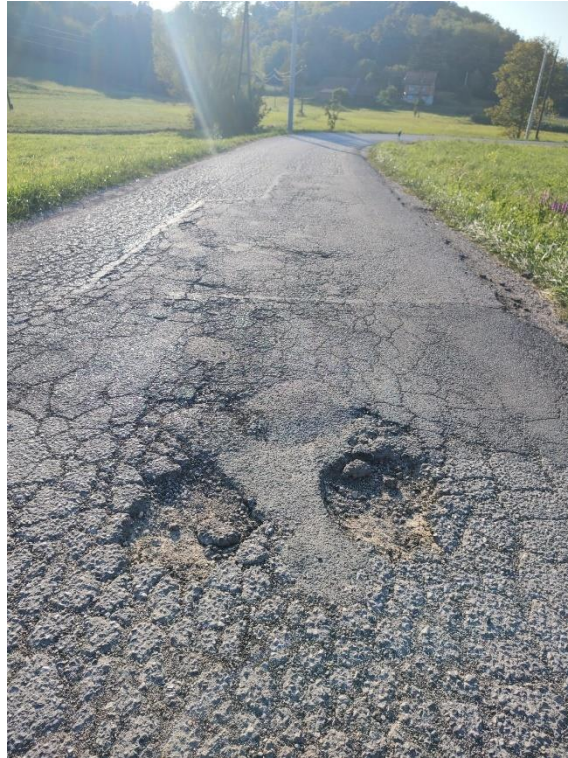
Slika 7: Udarne rupe na županijskoj cesti ŽC2119 (Mala Erpenja)
