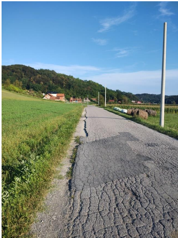
Slika 6: Oštećenje kolničkog zastora na županijskoj cesti ŽC2119 (Mala Erpenja)
