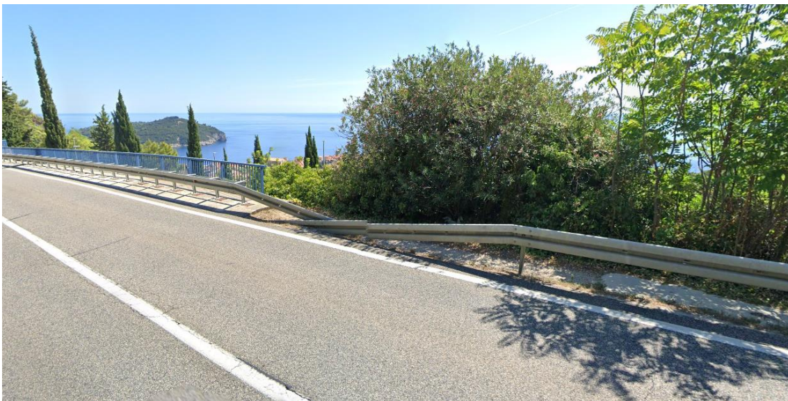
Slika 19. Neispravno izveden završetak/početak čelične zaštitne ograde – Primjer 3 Izvor:[23]
