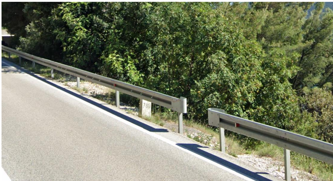
Slika 17. Neispravno izveden završetak/početak čelične zaštitne ograde – Primjer 1 Izvor:[23]
