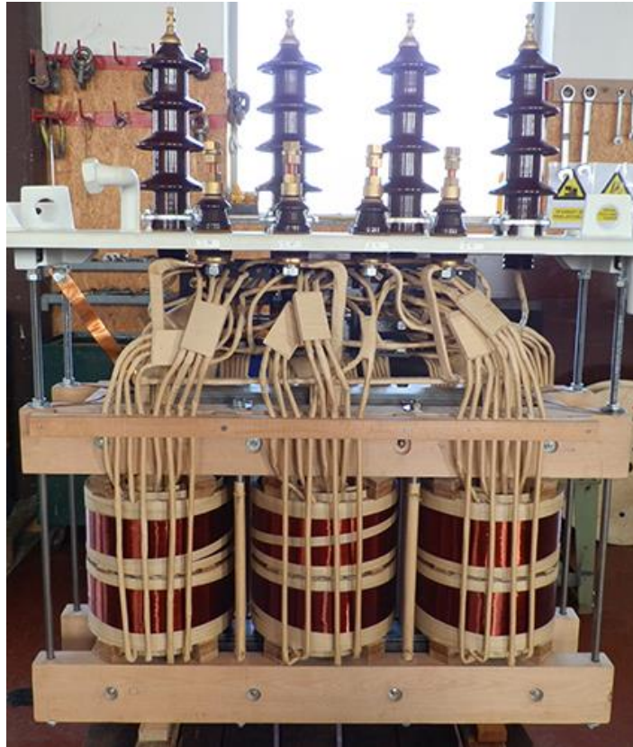
Slika 23. Izolacija trofaznog namota transformatora
