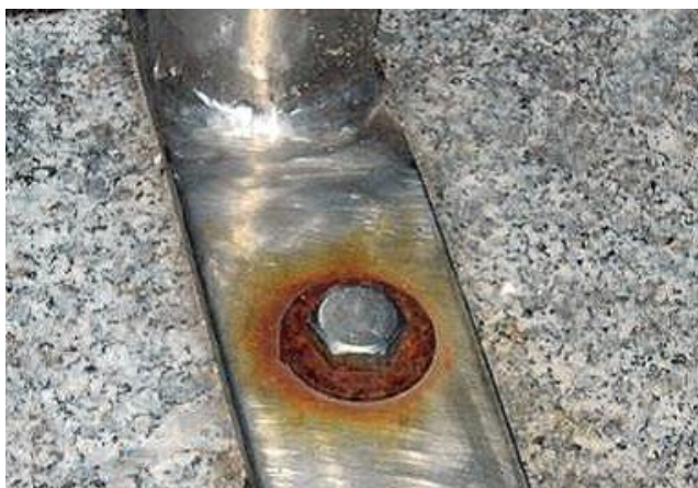
Slika 6. Primjer galvanske korozije [9]
