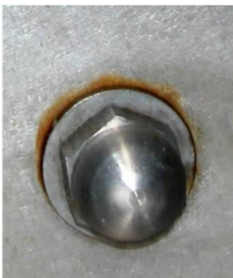
Slika 8. Primjer korozije u procjepu [13]
