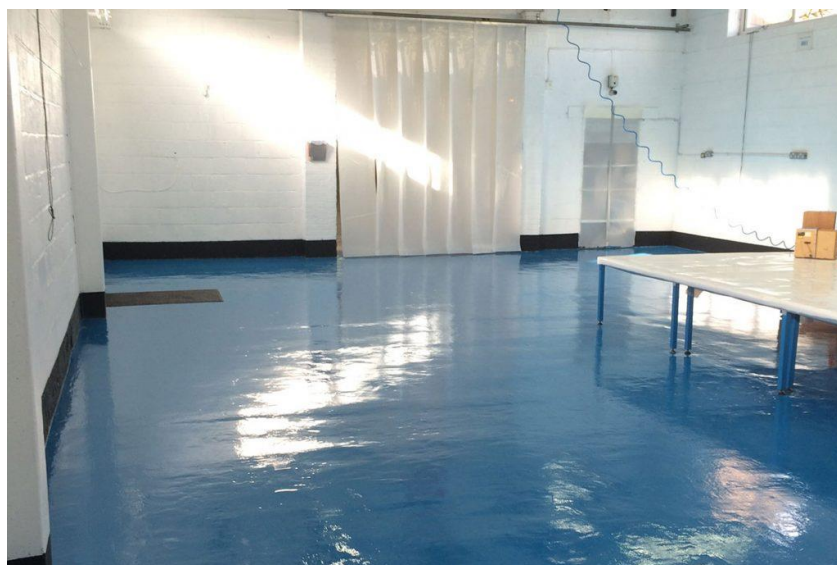
Slika 15. Pod od tekućeg epoksidnog premaza [25]
