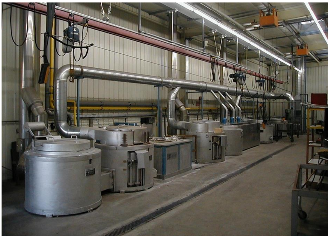
Slika 9. Uređaji za nitriranje u solnim kupkama [11]
