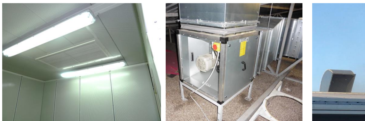
Slika 2.3. Sustav ventilacije ispitne kabine, lijevo – kabina, sredina – pogon, desno – ispuh
