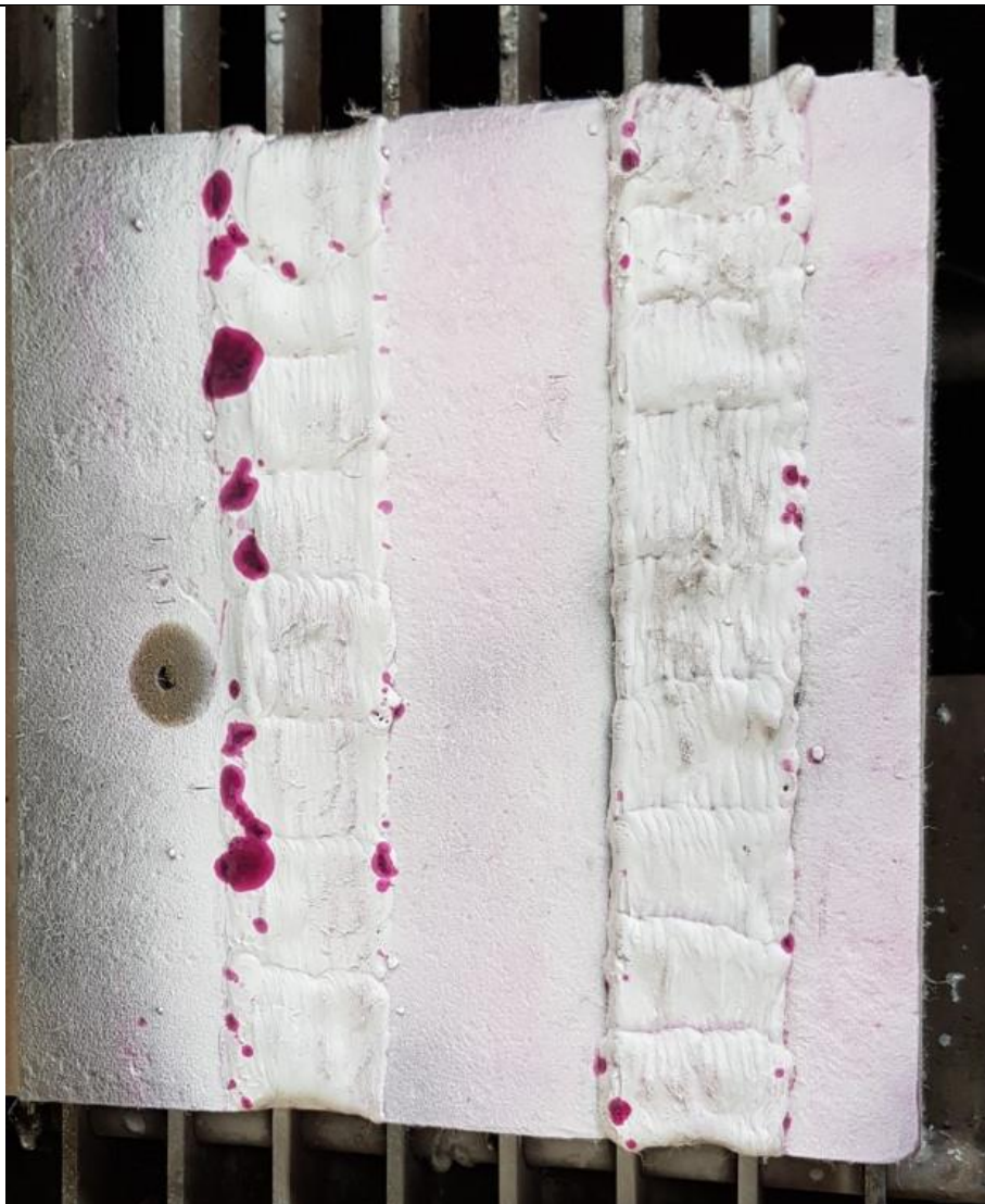
Slika 20 Penetrantsko ispitivanje pukotina
