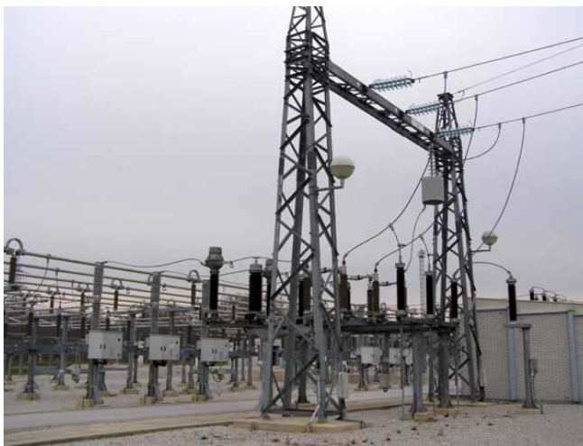
Slika 2 - 1: Mjerni transformatori ugrađeni na TS 400/220/110 kV Žerjavinec
