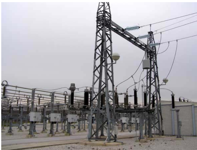
Slika 2 - 1: Mjerni transformatori ugrađeni na TS 400/220/110 kV Žerjavinec
