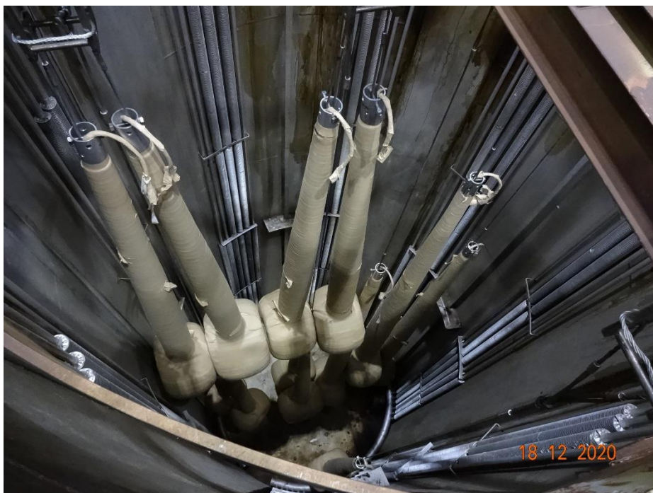
Slika 1.5. Punjenje vakuumske komore transformatorima prije procesa sušenja
