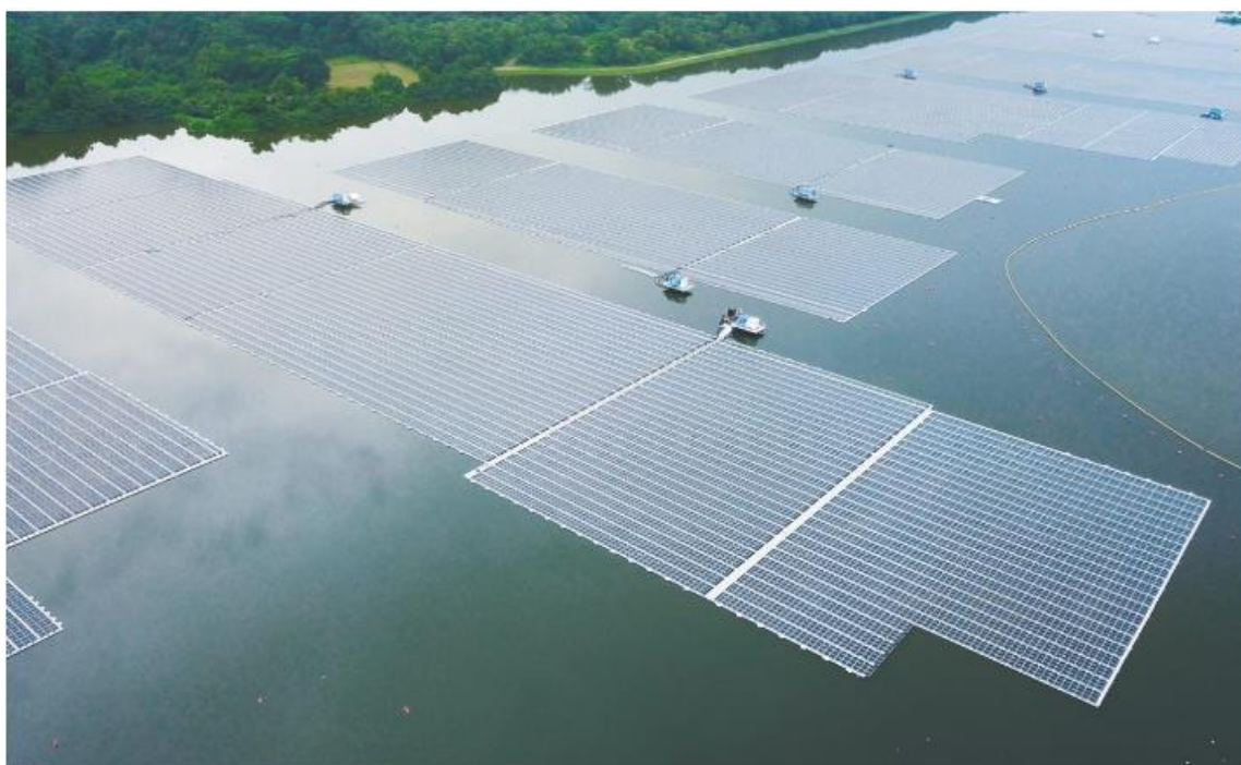
Slika 3.6 Sustav FPV, Sembcorp u Singapuru [18]
