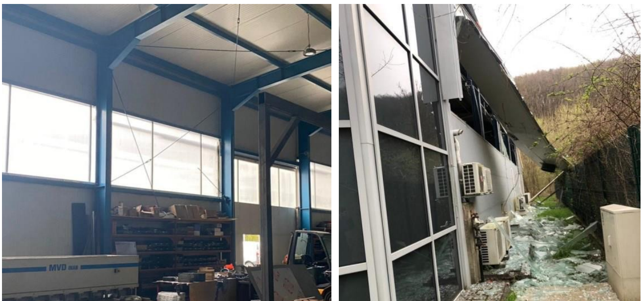
Slika 2 Fotografije otkazivanja dijagonala vezova u potresu, te oštećenja pročelja i stakala zbog velike fleksibilnosti okvirnih konstrukcija [4]
