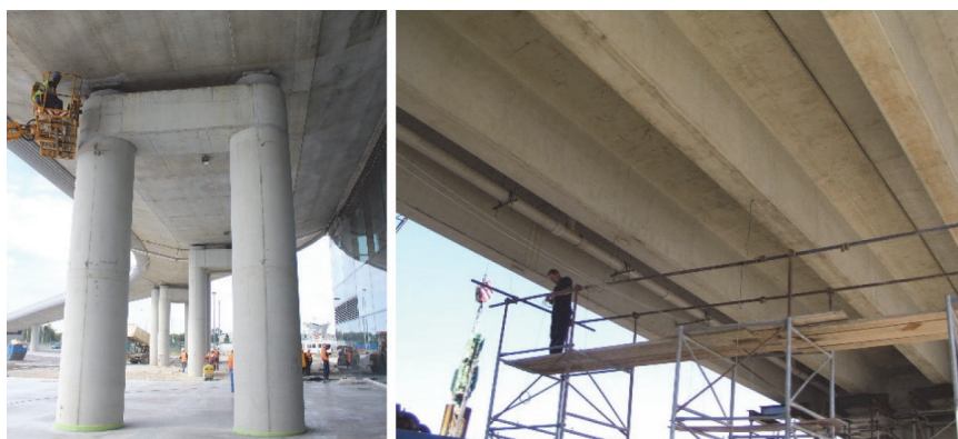
Slika 14. Postavljanje senzora s dizalice na vijaduktu u MZLZ i sa skele na nadvožnjaku Slavenska - Radnička u Zagrebu
