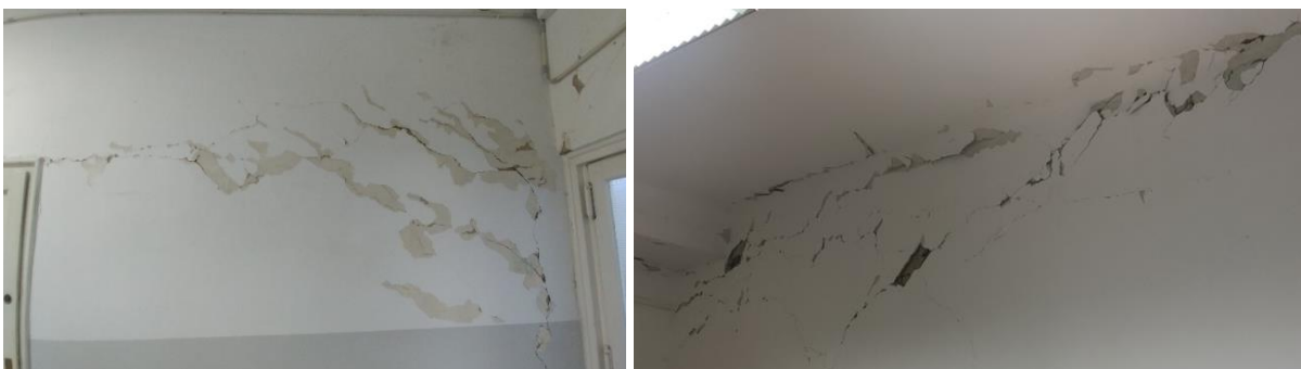
Slika 11.: Oštećenje ispunskog ziđa i pukotinsko oštećenje žbuke [7]
