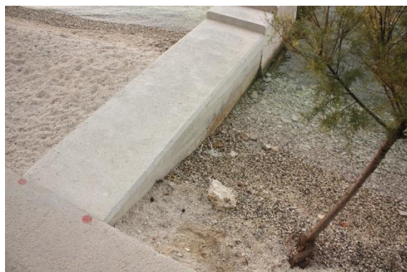
Slika 29. Otkrivenost stijena i stanjenost plaže uz betonski mol na DRN (4.11.2018.).
