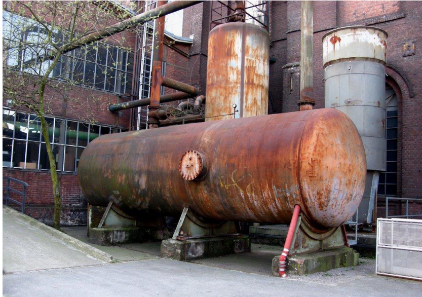
Slika 3-1. Primjer kemijske korozije ( https://www.shubbak.de/2014/03/21/corrosion/ , 08.09.2020.).
